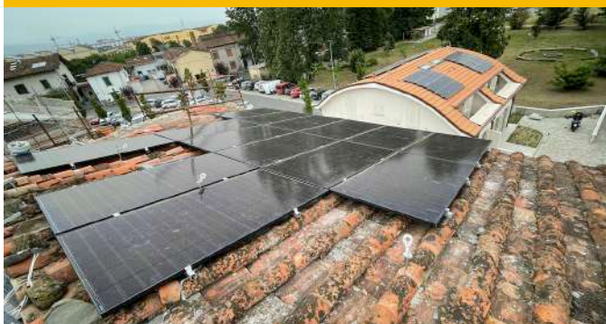
Moduli fotovoltaici e linea vita
