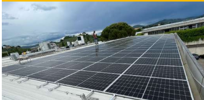
Impianti commerciali su tetto in lamiera grecata
