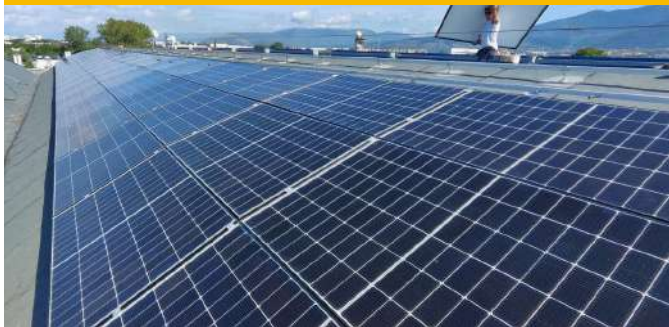
Impianti commerciali su tetto a cupola
