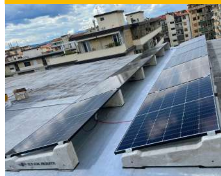
Impianti su tetto piano condominiale
